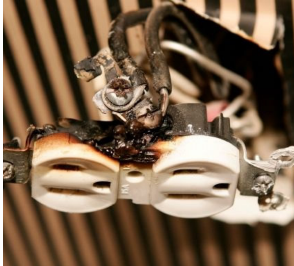
Photo F1 – Failure of aluminum wiring terminations
